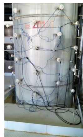
Рисунок 2 – Установленные УЗ излучатели на колонне КИ-1600 в ЦППР рудника
