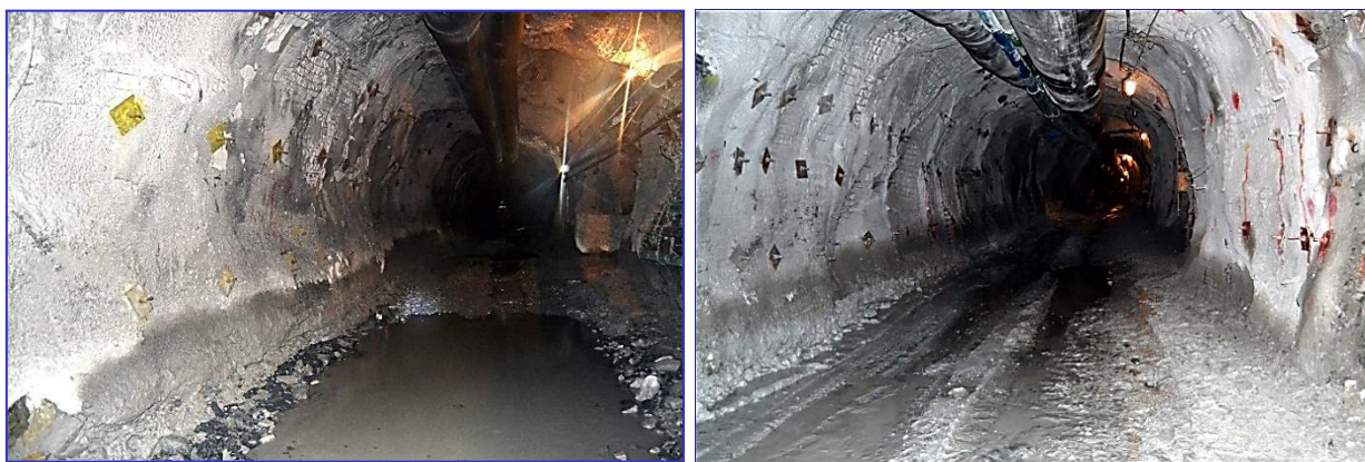
Рисунок 3 – Состояние выработок, пройденных на 18 горизонте Тишинского рудника с эллиптической формой сечения
