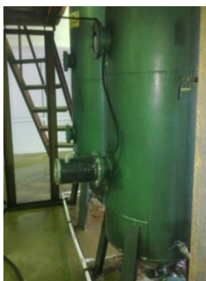
Рисунок 4 – Установка УЗ излучателя на сорбционную колонну СНК-640
